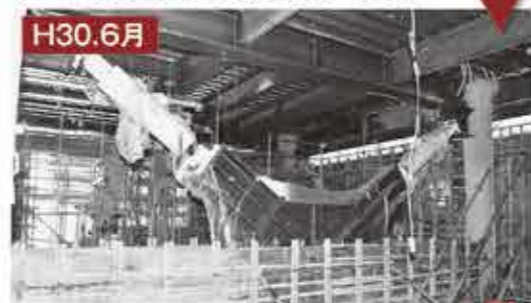
H30.6月 庁舎内部には地震の揺れを吸収する制振ダンパーが組み込まれました。
