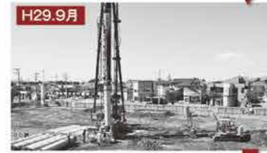
H29.9月 基礎を安定させるための杭が打ち込まれています。
