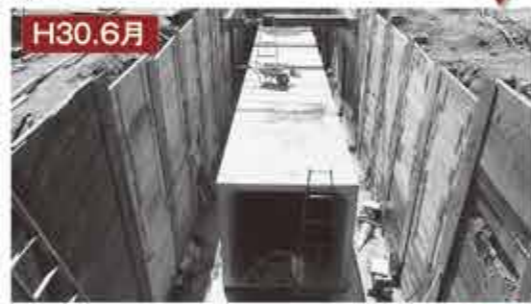
H30.6月 庁舎棟とエネルギー棟は、地下を通る設備配管用のトレンチで繋がっています。
