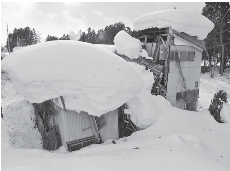
倒壊した空き家
