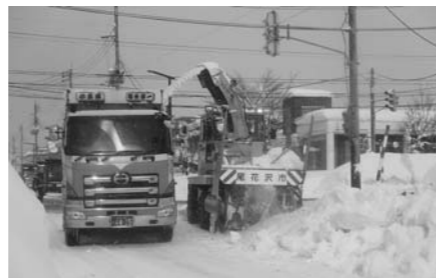
▲2m以上にもなる道路脇の雪壁。排雪作業を何度も行い、通行の安全を確保。
