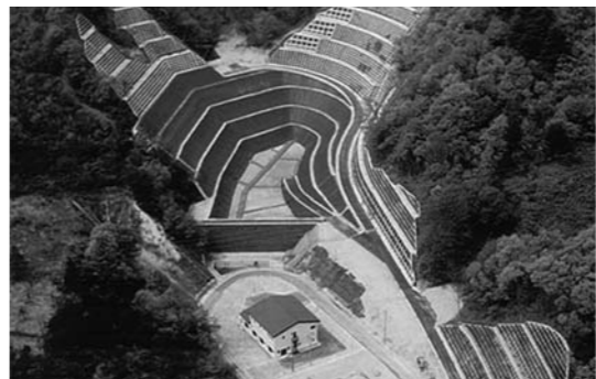
新白鷺処分場は、第5堰堤防工事により、今後10年間の延命化が図られる
