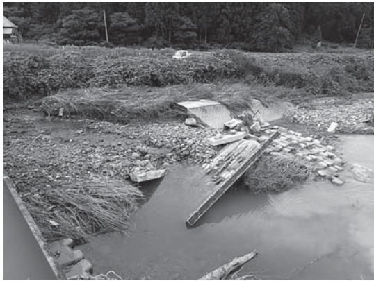
大雨により崩壊した河川構造物
