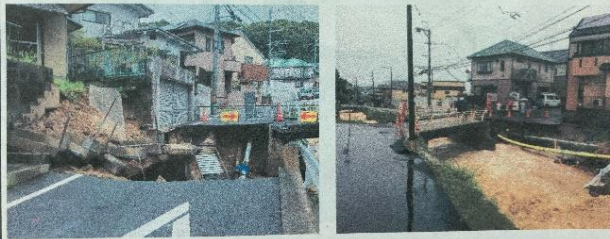
被害状況(榎川・みくまり病院付近)
