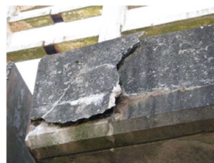
地覆コンクリートのうき
