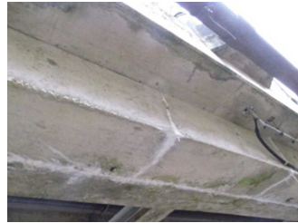
主桁ひび割れ
