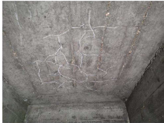
床版ひび割れ
