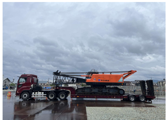
クローラークレーン搬入。基礎工事で使用する材料の移動を行うクレーンをトレーラーで搬入します。
