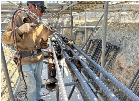
体育館棟の基礎鉄筋工事。鉄筋をガスバーナーの高温で接続する、圧接作業中です。
