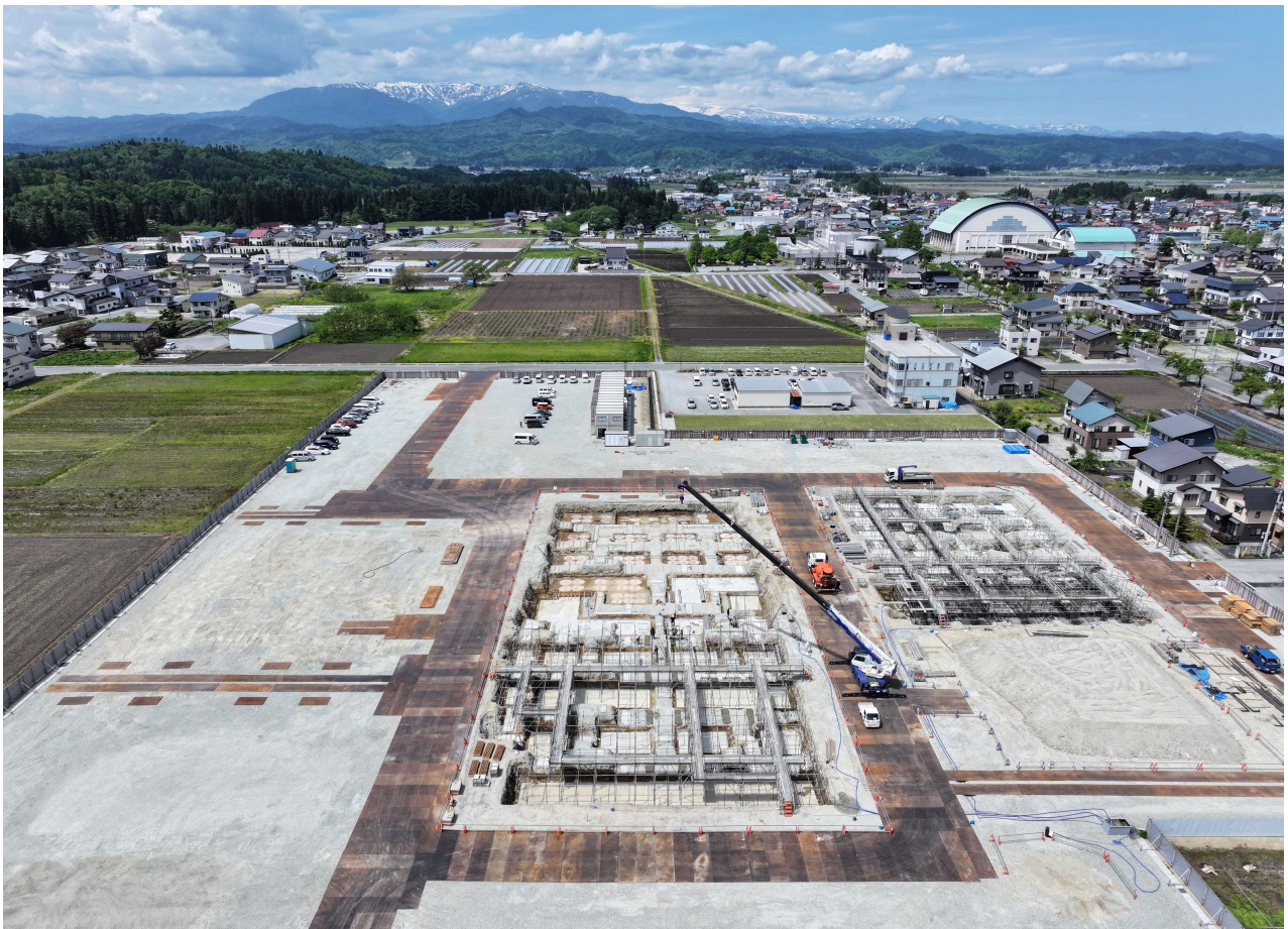
東側上空から。中央が校舎側で、右側が体育館になります。左側は交流棟で6月から掘削開始です。
