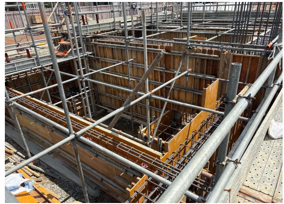
体育館棟の基礎型枠工事。鉄筋作業が終わった箇所からコンクリートの容器となる型枠を組み立てます。
