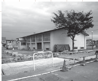
昨年11月、サルナート武道館前の歩道に放熱パイプを埋設。
