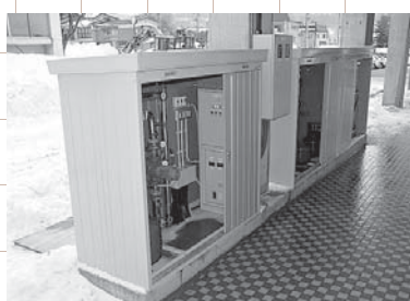
完成した機械制御室。ヒートポンプを併用して、更に融雪を促進することが可能。
