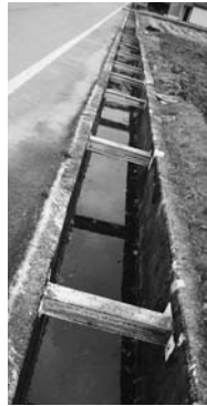
市道西原線側溝
