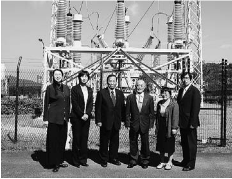
八丁原地熱発電所(大分県玖珠郡九重町)
