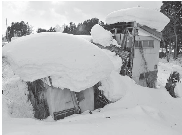
倒壊した空き家
