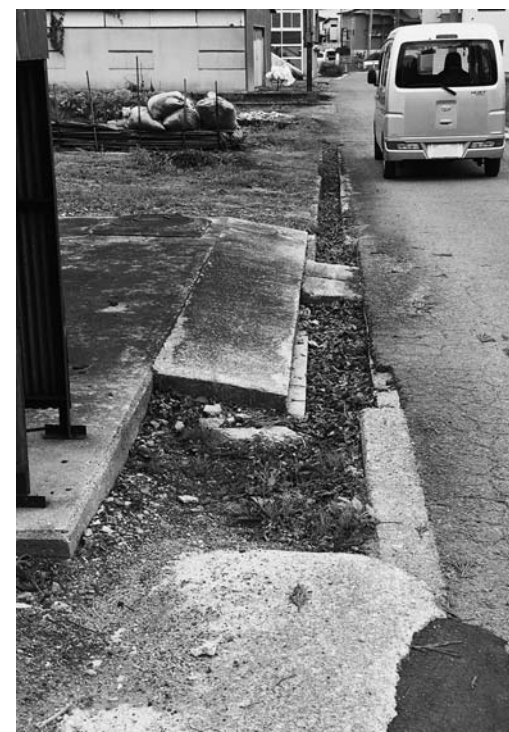
フタのない側溝
