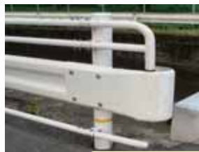
ガードレール
